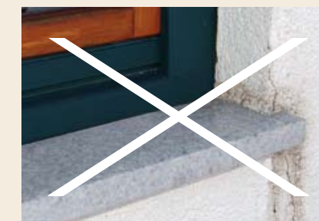
Falsch montierte Fensterbank
